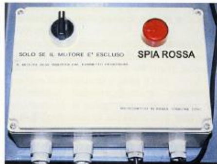
QUADRO COMANDO MOTORE DI ASPIRAZIONE
