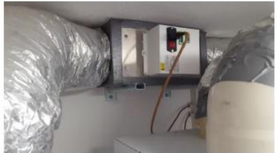
Applicazione su canale di mandata della ventilazione meccanica
