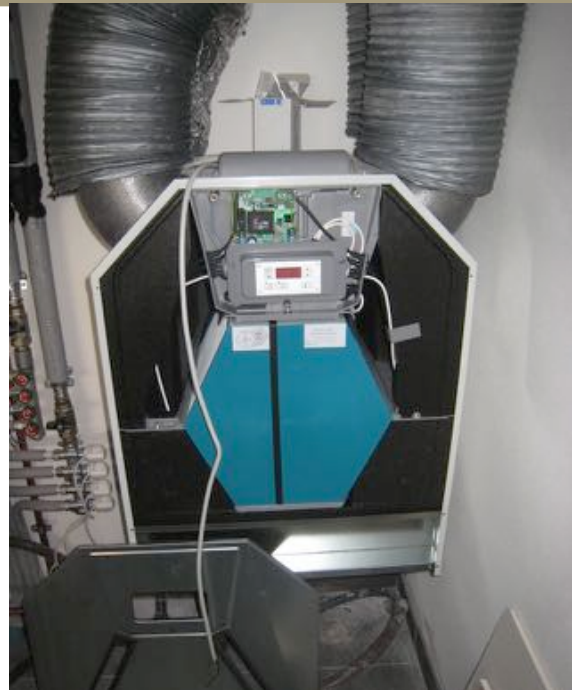
Macchina della Ventilazione Meccanica Controllata
